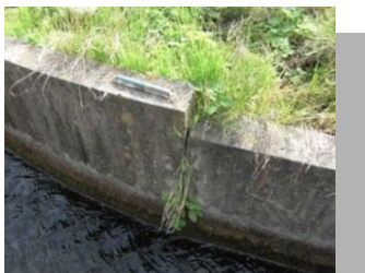
■ 水路の老朽化による沈下
