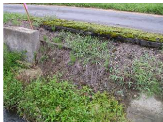
■ 農道路肩の崩壊
