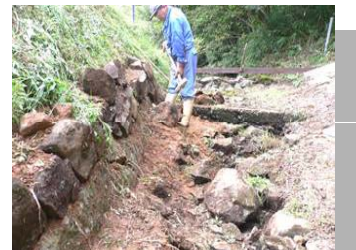
■ 老朽化により土砂が堆積した洪水吐
