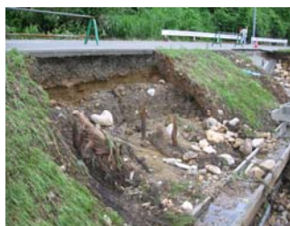
■ 農道法面の崩壊
