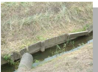
■ 水路側壁の倒壊
