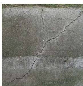
斜め方向のひび割れ
