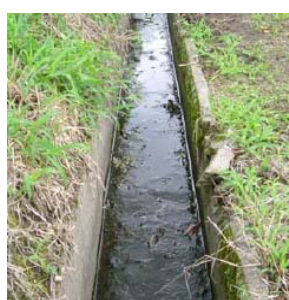
部分的な欠損
