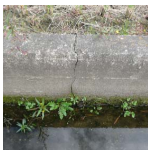
縦方向のひび割れ
