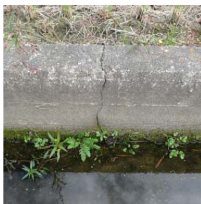
縦方向のひび割れ
