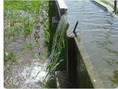
水路からの部分的な溢水
