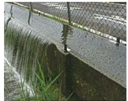
水路からの溢水
