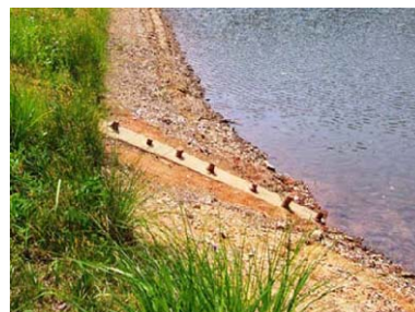
老朽化した取水施設
