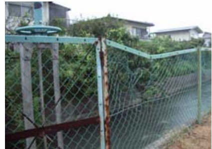
破損した金網フェンス
