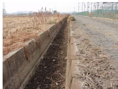
安全施設がない水路
