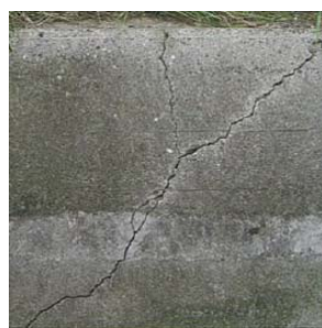
斜め方向のひび割れ
