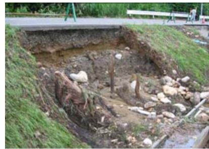
道路法面の崩壊
