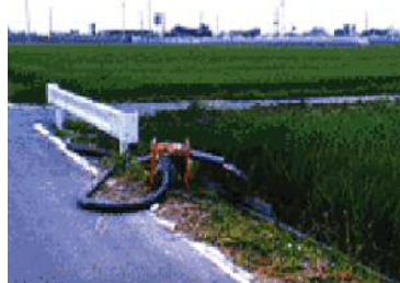
【農業用水の反復利用】 反復利用のためのポンプ設置
